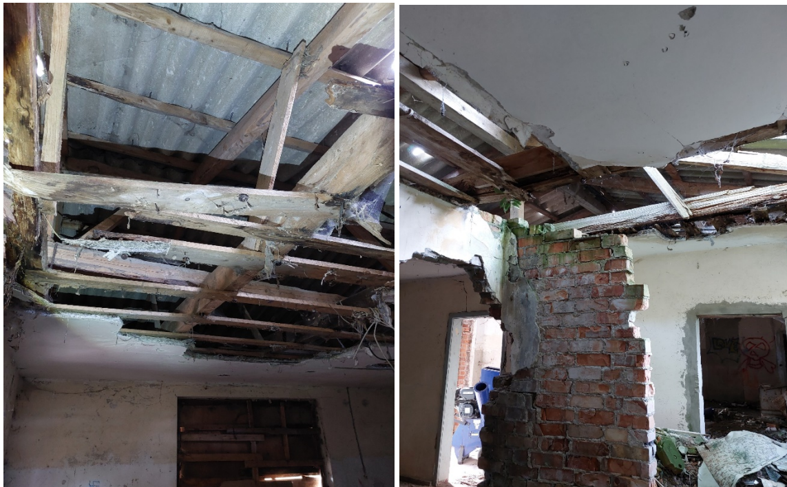
Abbildung 13: Innenansicht ehemaliges Konsumgebäude mit beschädigtem Asbestdach
