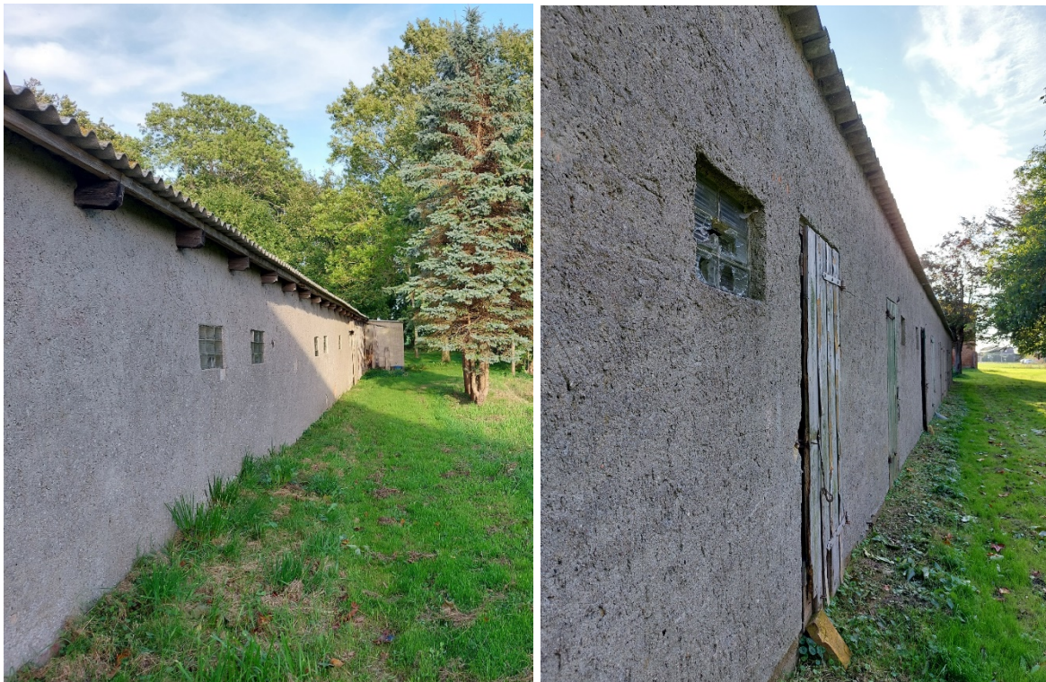
Abbildung 14: Schuppenkomplex von außen, ebenfalls mit Asbestdach
